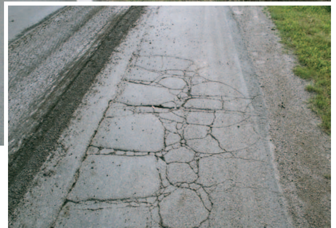
Zustand der K 81 vor der Sanierung
