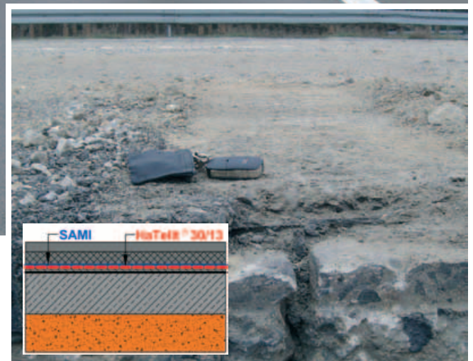
Abbruchstelle im Zuge des Ausbaus der BAB 13 im Jahr 2005 - Reste des Asphaltbinders über HaTelit® - ohne sichtbare Rissbildung
